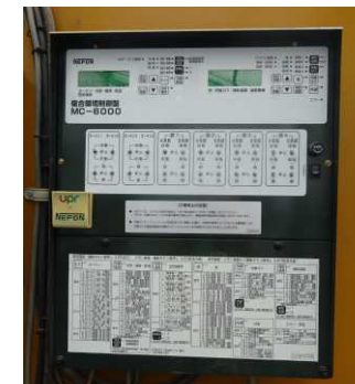
複合環境制御盤*6
